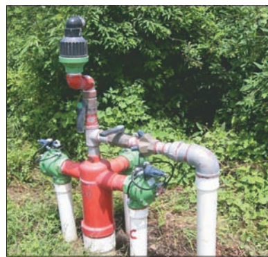
Sistema de Válvulas y llaves.
